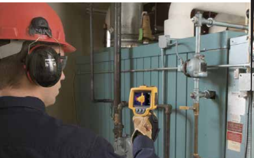
보일러를 사용하는 시설이라면 스팀 라인을 스캔하여 누출, 막힘, 고장 난 트랩이 있는지 확인합니다.
